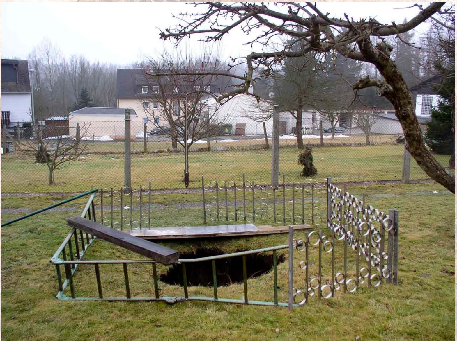
2003 eingestürzter Lichtschacht des Sankt-Georg-Stollens - Nähe Gartenstraße
