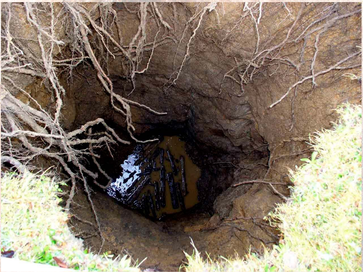
Blick in den eingestürzten Lichtschacht
